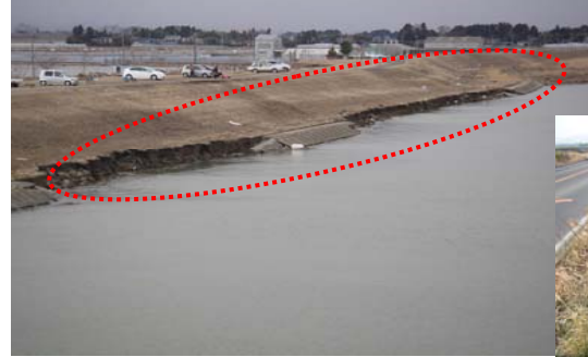
堤防一部洗掘
